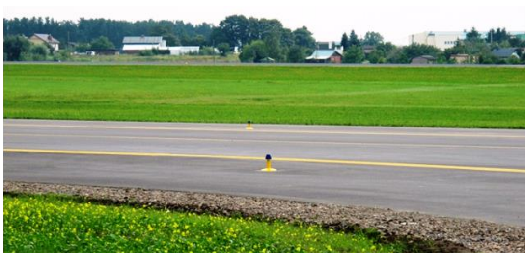
Oświetlenie krawędziowe dróg kołowania – niebieskie.
