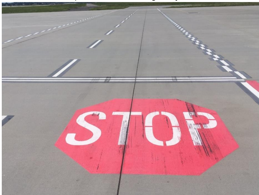
Oznakowanie STOP na drogach serwisowych.
